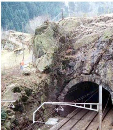
Ursprünglicher Zustand: instabiler Felskopf
