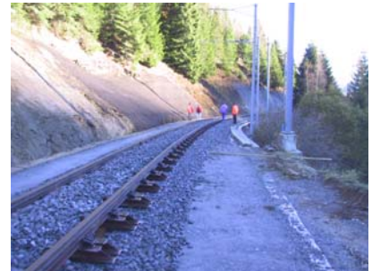
Hangsicherung mit Felsvernagelung, Oberbau mit Y-Schwellen
