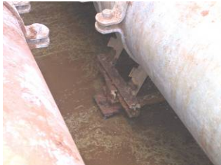
altes korrodiertes Gleitlager
