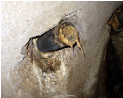
Vorstehender, nicht verputzter seitlicher Anschluss.
