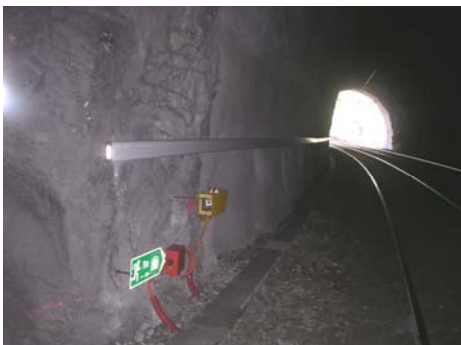
Selbstrettungsmassnahmen: Beleuchtung, Handlauf, Fluchtwegbeschilderung
